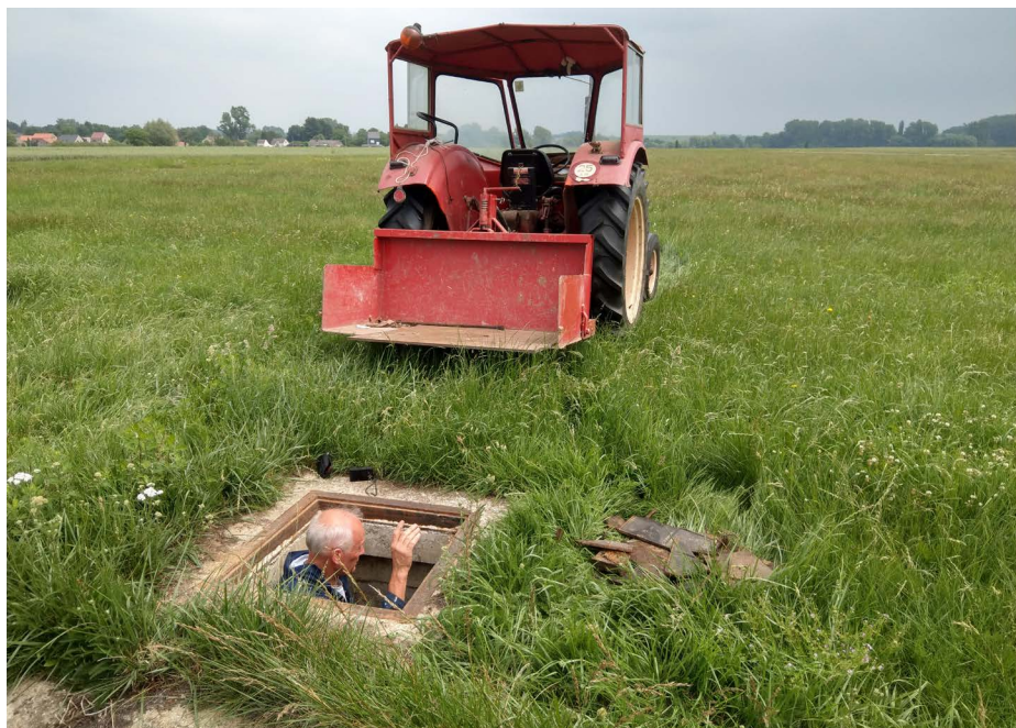
Langs de 24 werd een putdeksel beschadigd. De brokstukken werden eerst verwijderd.
